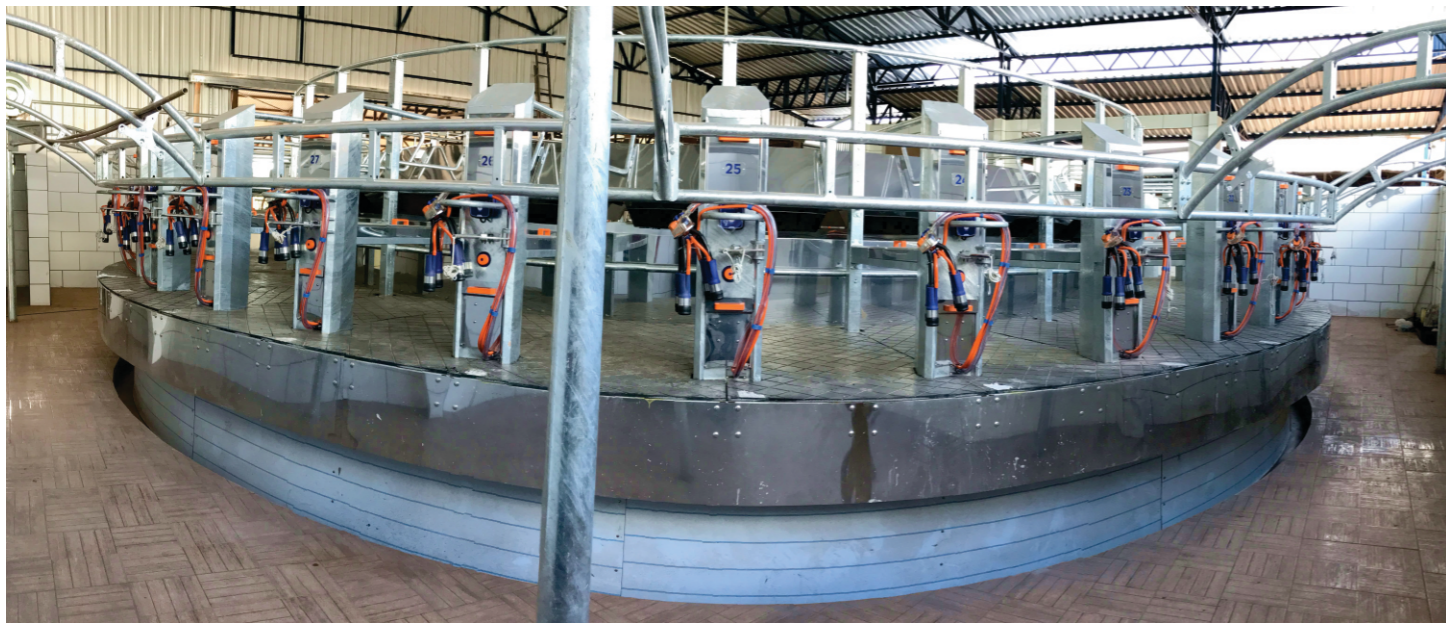
Carrossel com 36 pontos de ordenha, instalado na cidade de Condor, Rio Grande do Sul.
